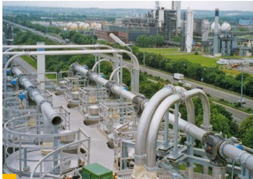
Bild 11: Verrohrung einer Chemieanlage mit Produkten aus Sonderlegierungen
