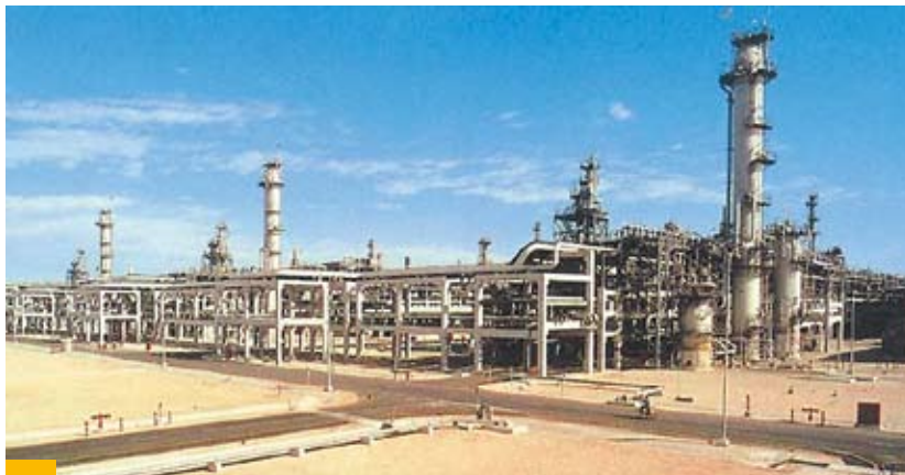
Bild 31: Rohrleitungen für Rauchgasentschwefelungsanlage in Katar
