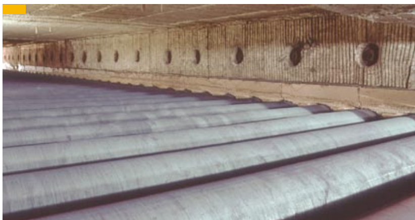
Ofen ThyssenKrupp VDM – kalter Zustand
